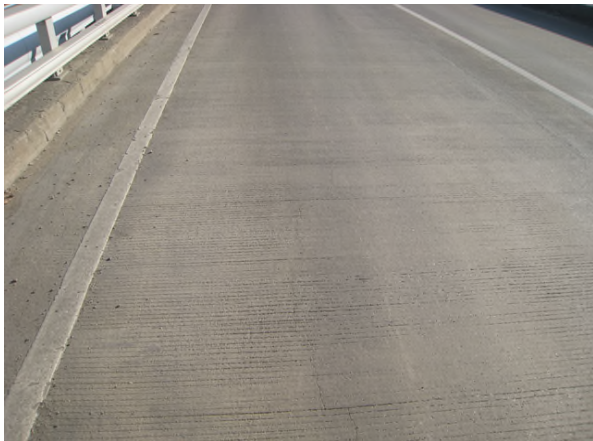
서울방향 교면포장 S2 망상균열(3.0×15.0)
