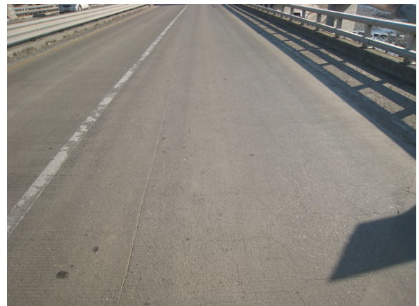
춘천방향 교면포장 S1 망상균열(3.5×10.0)
