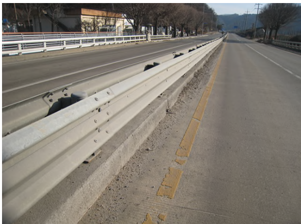
춘천방향 교면포장 S1 토사퇴적(1.0×15.0)
