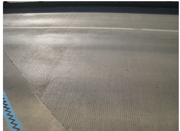
서울방향 교면포장 S3 망상균열(5.0×8.0)
